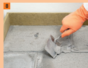
8 Het teveel aan lijm wordt met een troffel verwijderd en opnieuw gebruikt.
