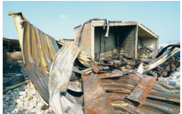
Typisch beeld: Uit een grote brand komt een uit cellenbeton vervaardigde loods nagenoeg onbeschadigd. De rest van de fabriek was volledig verwoest door de vlammen.
